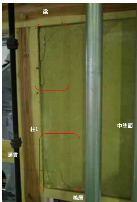
図 M_3 中塗側 1/30rad 隅角部のひび割れ
