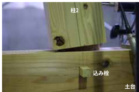
図N_10 中塗り側 1/12rad 柱2-土台接合部のホゾの折損
