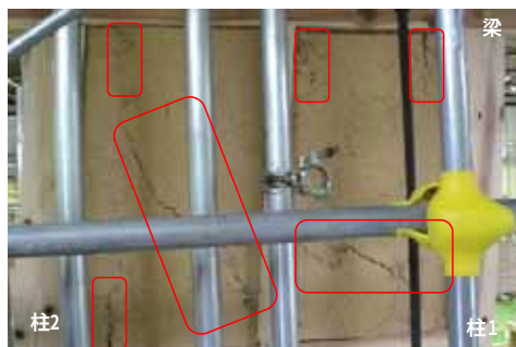
図N_13 裏返し塗り側 1/10rad ひび割れ拡大
