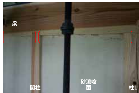
図1.2 砂漆喰側 1/100rad 隅角部圧壊
