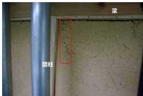
図M_8 裏返し塗り側 1/15rad 縦間渡し竹に沿ったひび割れ
