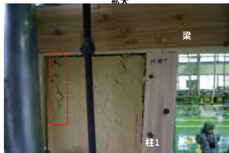
図M_10 裏返し塗り側 1/12rad 縦間渡し竹に沿ったひび割れの拡大
