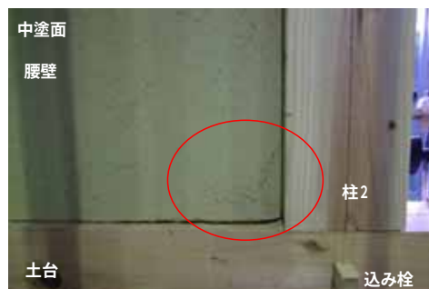
図 1.6 中塗側 1/50rad 柱2-土台隅角部のひび割れ
