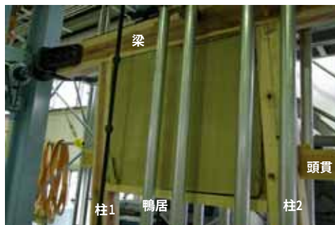
図N_8 中塗り側 1/12rad 隅角部のひび割れ拡大
