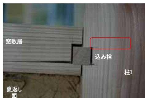
図 1.5 裏返し側 1/50rad 込み栓による窓敷居のせん断力によるひび割れ
