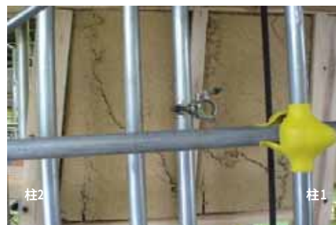
図N_17 裏返し塗り側 1/8.6rad 垂れ壁ひび割れの拡大
