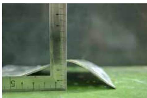
図 K_13 梁側筋かいプレートの変形 (30mm)
