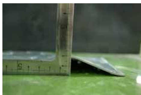
図 K_14 土台側筋かいプレートの変形 (20mm)
