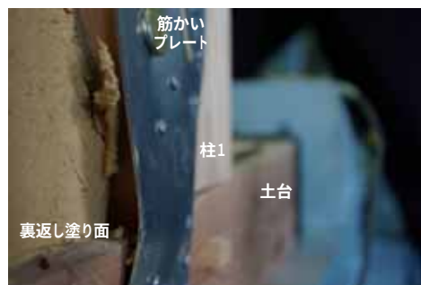
図 K_8 裏返し塗り側 1/17rad 土台筋かいプレートの変形
