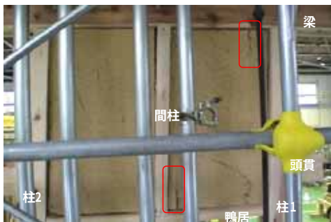
図N_7 裏返し塗り側 1/20rad 縦間渡し竹に沿ったひび割れ
