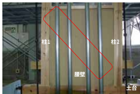
図I.10 中塗側 1/30rad 一方方向加力時の腰壁のせん断ひび割れ
