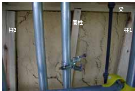
図I_16 裏返し側 最終加力時1/8.6rad 垂れ壁ひび割れ
