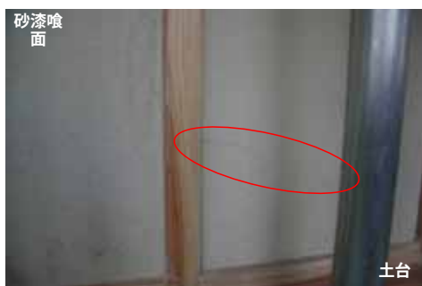
図1.4 砂漆喰側 1/100rad 地貫のこじり効果と間柱と土台によるひび割れ
