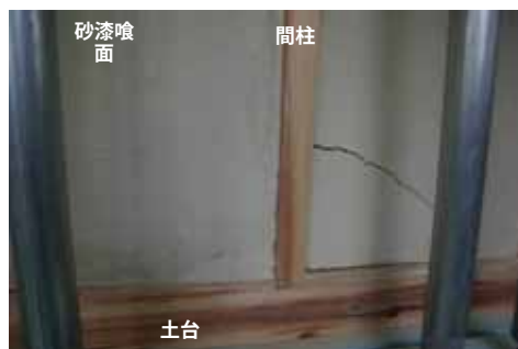
図I.9 砂漆喰側 1/30rad 間柱と土台による砂漆喰のせん断ひび割れの拡大
