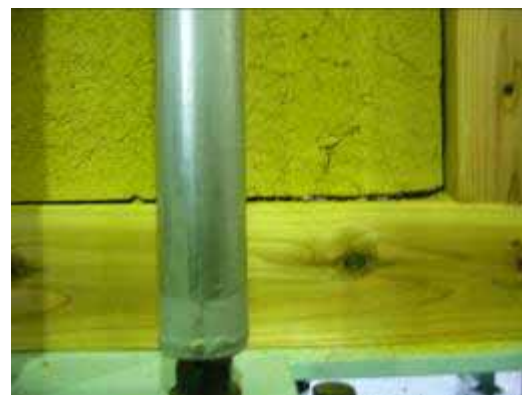
写真 3.4.1 C-1 土台-土壁の隙間
