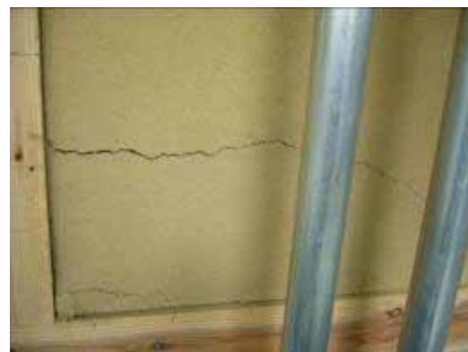
写真 3.4.5 C-3 水平貫に沿ったひび割れ
