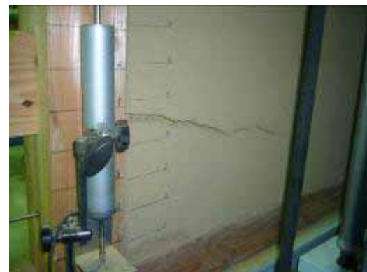
写真 3.3.6 B-1 水平貫に沿ったひび割れ
