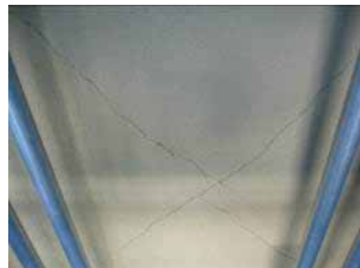
写真 3.3.7 B-2 中塗り面のせん断ひび割れ
