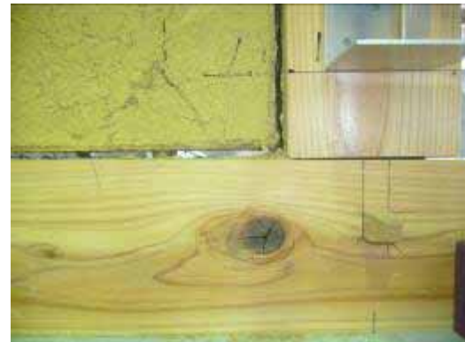
写真 3.3.1 A-1 土台・軸組みの隙間
