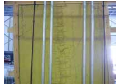
写真 4.3.1 縦貫・間渡し竹のひび割れ
